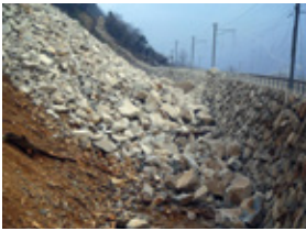
DESPRENDIMIENTO DE ROCAS
