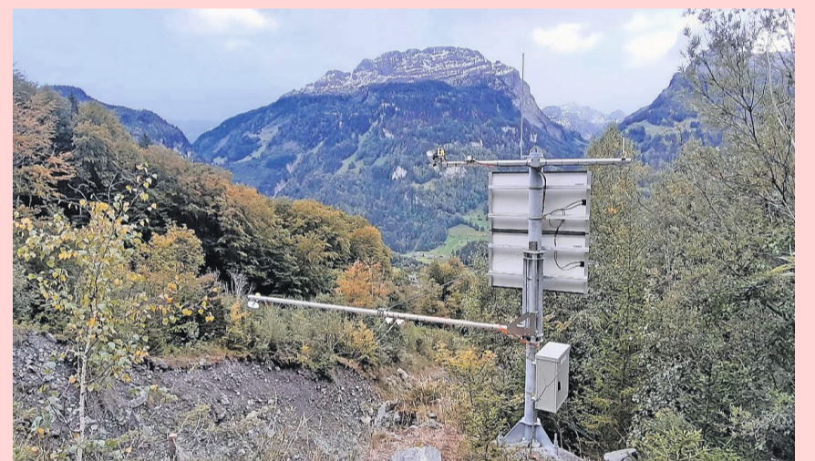
Die Detektionsanlage im oberen Bereich schlägt bei Hochwasser oder einem Murgang Alarm und sendet Signale an Ampeln im Bereich dreier Brücken. Bild: Kurt Imhof
