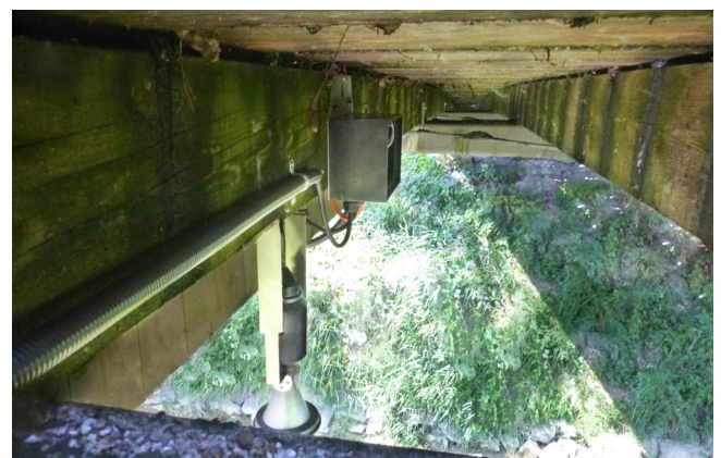
Abbildung 3: Ein Pegelradar, das unter einer Fußgängerbrücke montiert ist.
