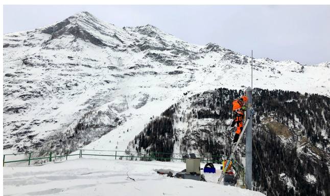
Figure 2 : L'équipe de Geoprevent installe le radar d'avalanche: en arrière-plan, les pentes à surveiller à la Garde de Bordons.
