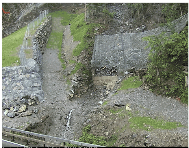
Abbildung 4: Steinschlagdamm mit Schutznetzen.
