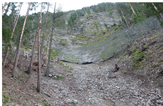
Figure 4 : Le chantier est principalement menacé par deux couloirs qui ont du être sécurisés sur toute leur longueur.
