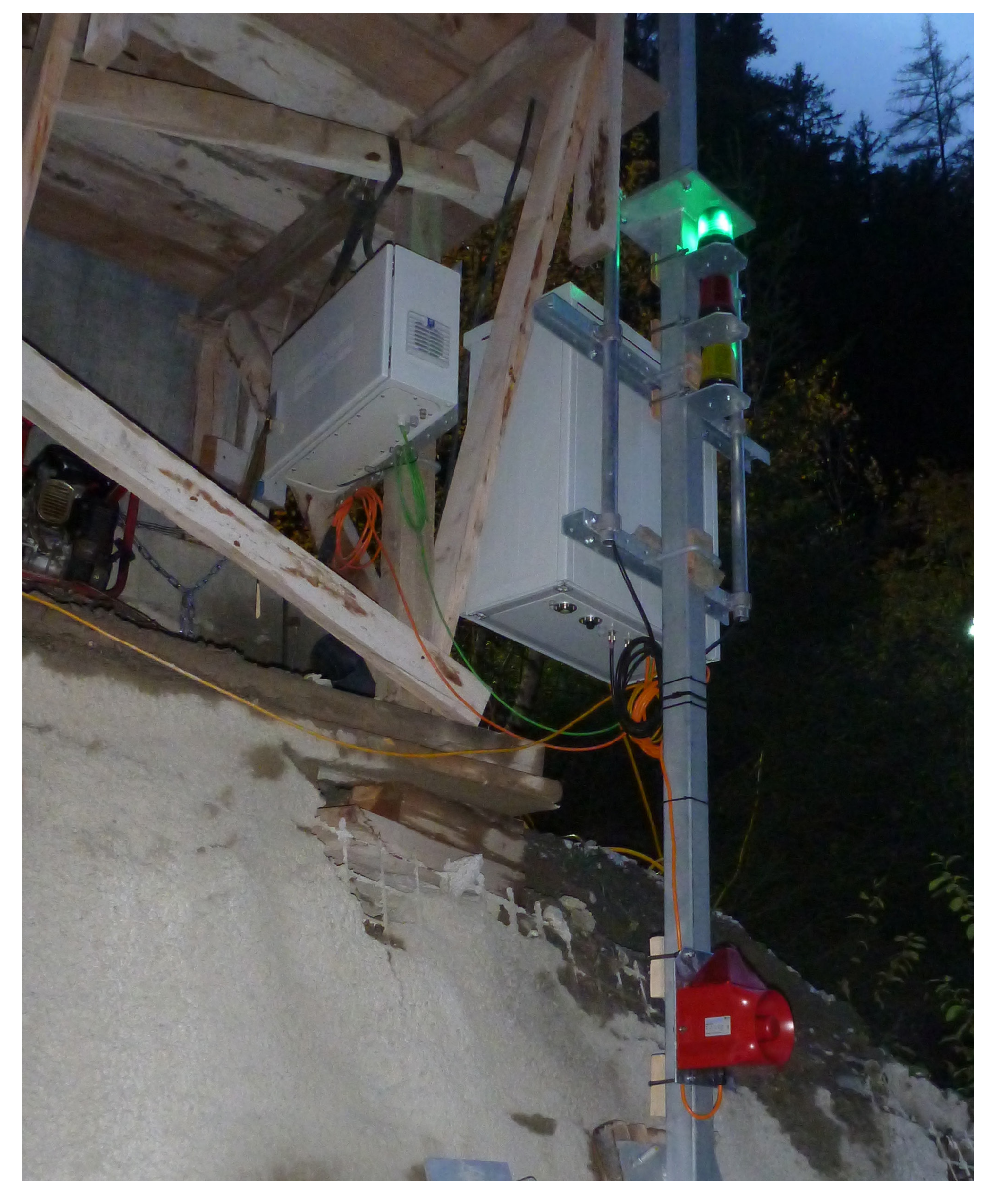
Auf der Baustelle empfängt die Basisstation alle Signale der Sensoren. Die grüne Leuchte zeigt an, dass das System einwandfrei funktioniert. Im Ereignisfall wird das darunter montierte Alarmhorn aktiviert, damit die Baustelle umgehend evakuiert werden kann.
